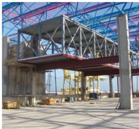
Debajo de la helisuperficie se ha instalado un pasillo dotado con una mampara de separación de los flujos de salidas y llegadas.
